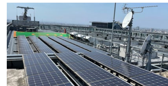
渋谷PARCO屋上に設置されている太陽光パネル
